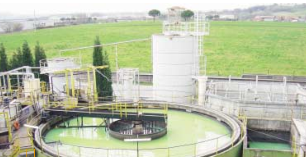
Bassin de traitement des eaux usées sur le site de production de tubes cathodiques à Anagni.
